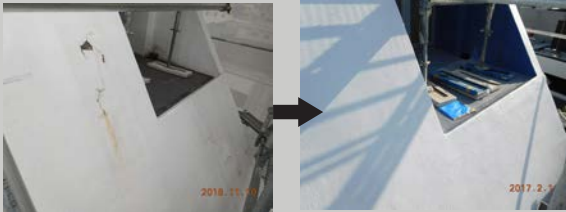
塔屋外壁北面：過去の補修箇所が再び破損していた
