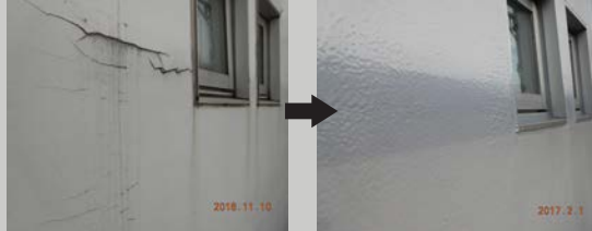
3F外壁西面：破損箇所がかなり大きかった箇所
